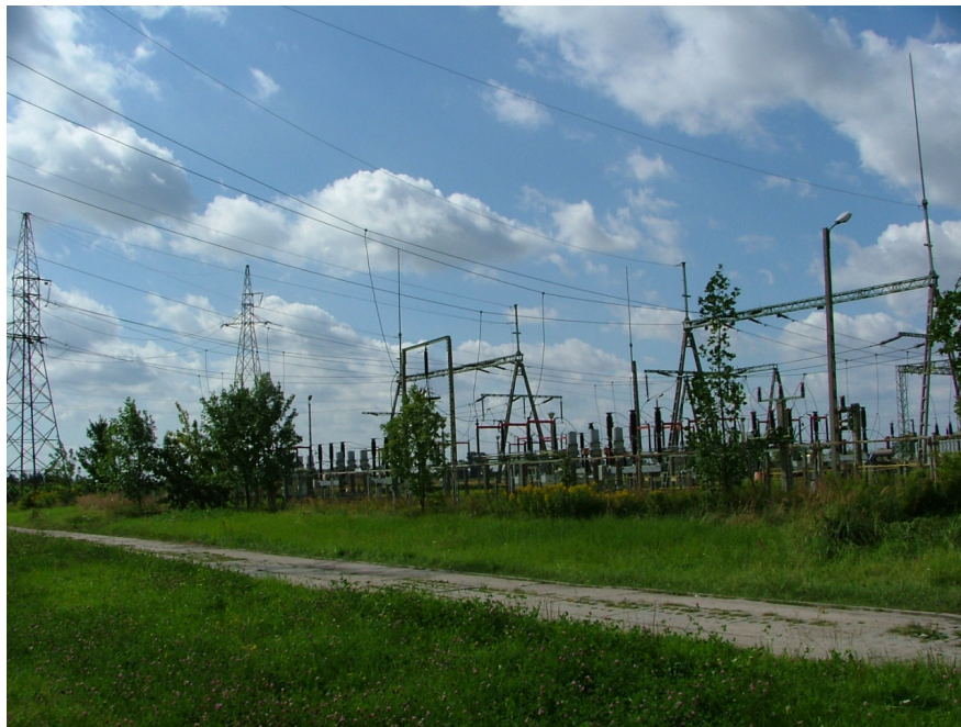
Fot.1. Widok stacji transformatorowej 110/15 kV Leszcze
