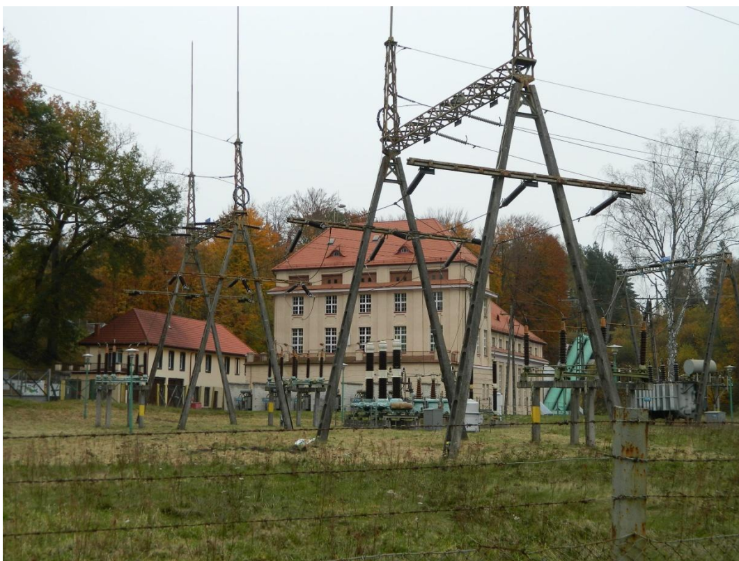
Ryc. nr 15. Stacja GPZ Gałąźnia Mała – zakończenie linii (fot. A. Sito).
