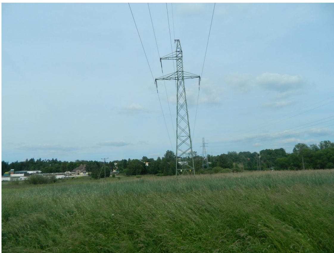
Ryc. nr 3. Przejście linii nad rzeką Bytówą – prawy brzeg, okolice GPZ Bytów (fot. A. Sito).
