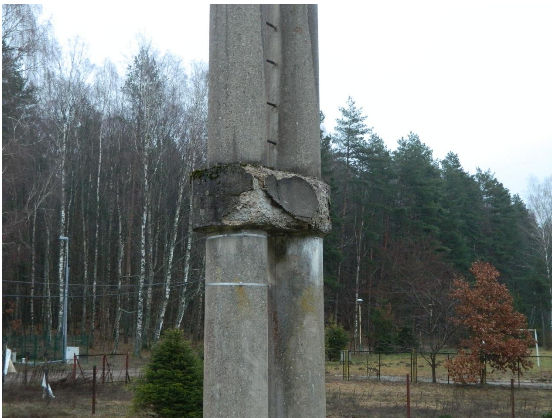
Ryc. nr 2. Skorodowany, przedwojenny słup serii N w Krzyni (fot. A. Sito).
